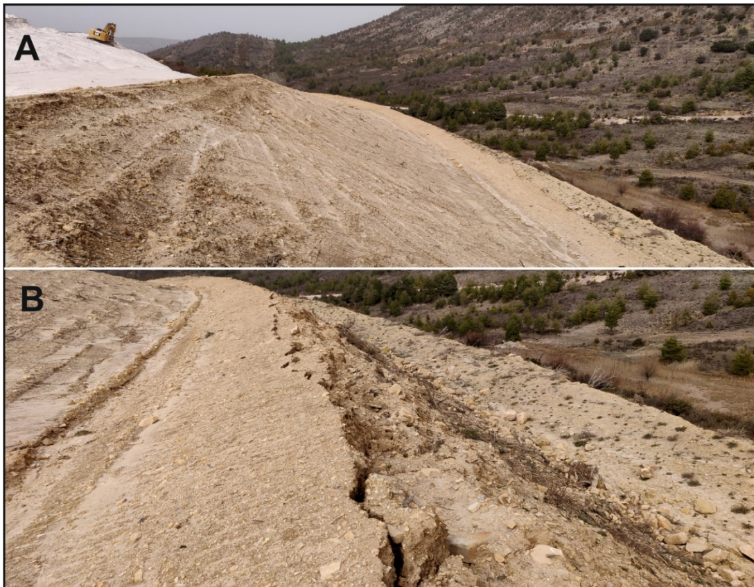
Figura 15. Dos taludes contiguos con diferente ángulo: (A) 20°; (B) 45°. Claramente se puede ver cómo tras un año de su construcción, el primero no presenta ningún signo de erosión, y el segundo tiene pequeños deslizamientos en los bordes de terraza.
