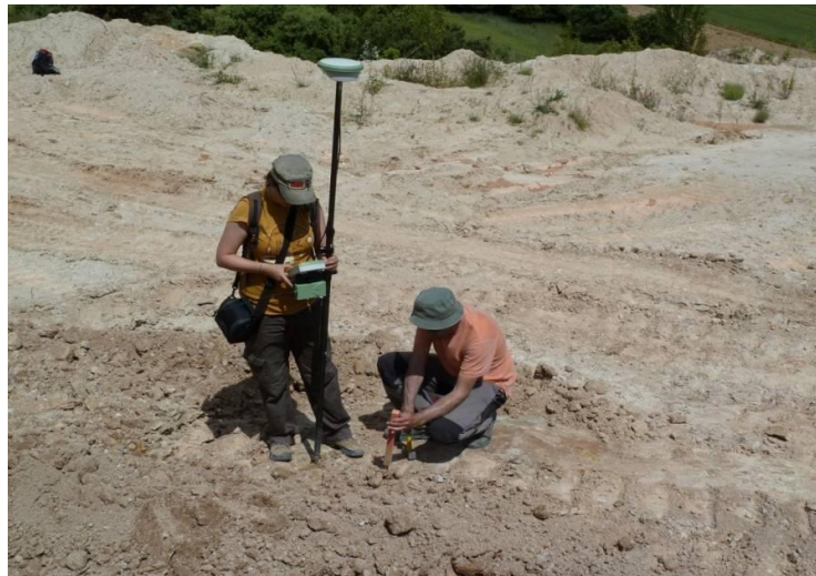
Figura 8. Trabajos de replanteamiento topográfico para la construcción del relieve diseñado con GeoFluv-Natural Regrade en la cantera de Somolinos (Guadalajara, España)
